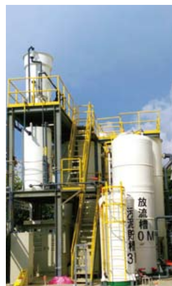
▲ 茂迪廠區廢水處理設備
