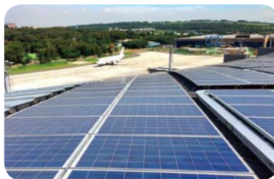
▲ 中部機場 (120KW)
